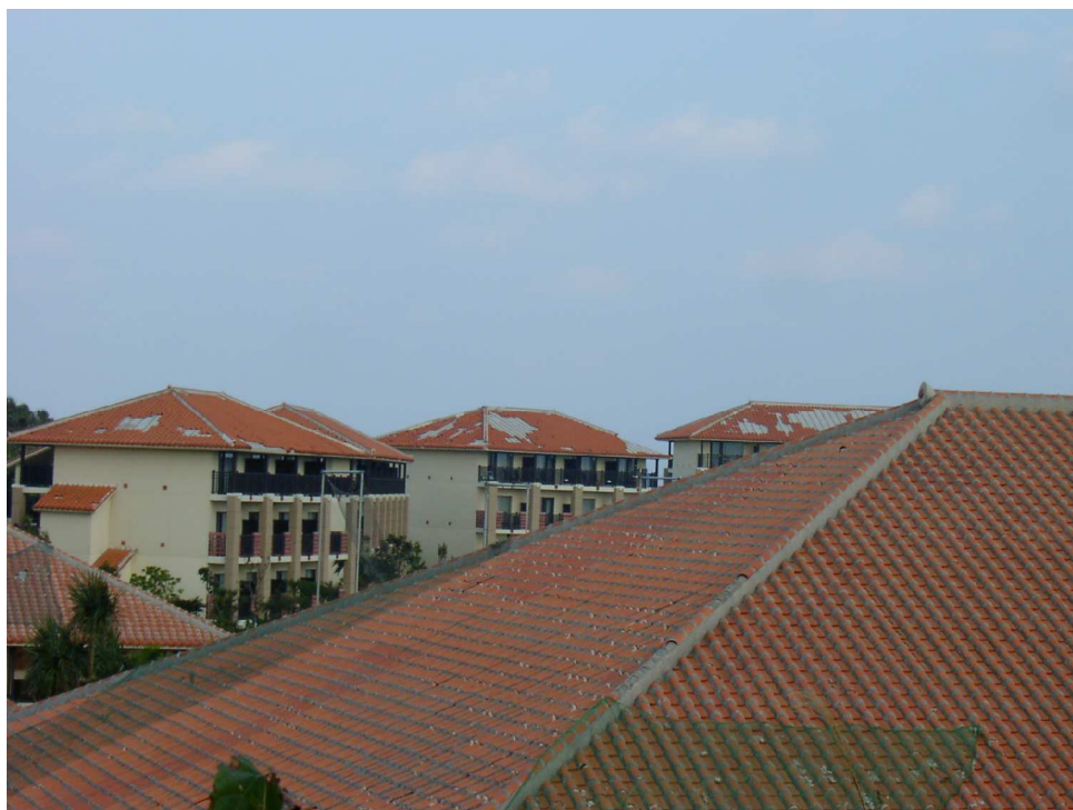
平成 18 年台風 13 号による被害状況
