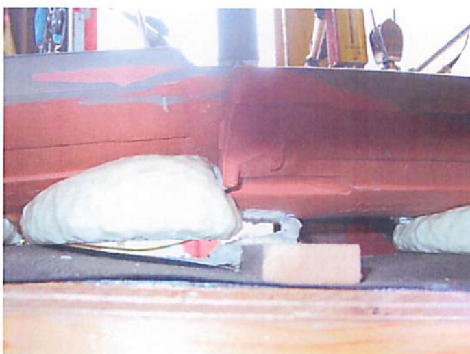
写真-13 破断状況(S型粘土瓦, No.1, 標準施工)
