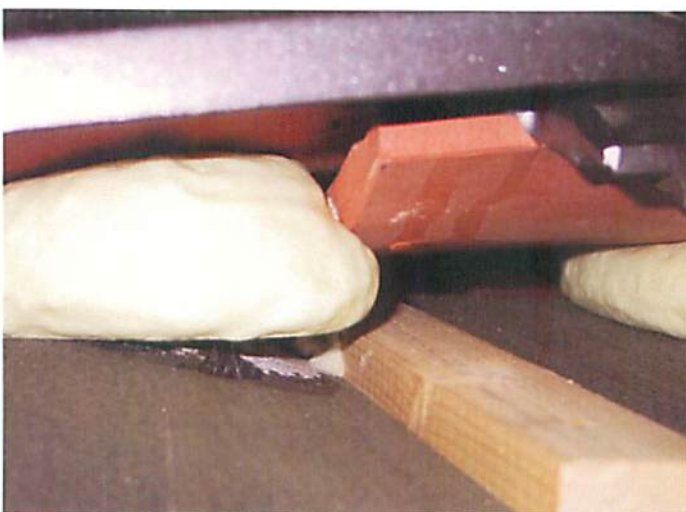
写真-17 破断状況(J型粘土瓦, 改修施工)
